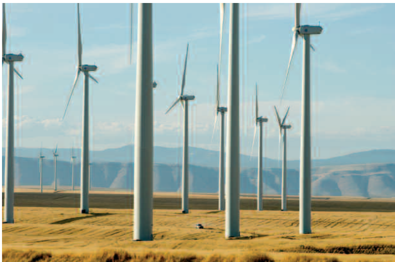
– Figura 3. Turbinas verticales para la captura de energía mediante el viento. Son un prodigio de diseño aerodinámico, probablemente mejor que cualquier ala de avión.
